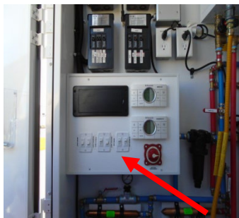
12 Volt Switches in Unit
