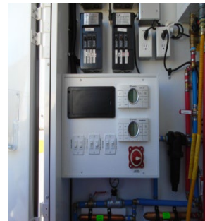
12 Volt Converter Panel Switches
