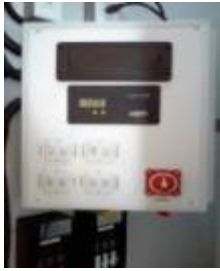
12 Volt Converter Switches
