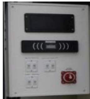
12 Volt Converter Panel Switches
