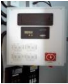
12 Volt Converter Switches
