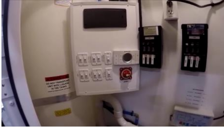
12 Volt Switches in Unit
